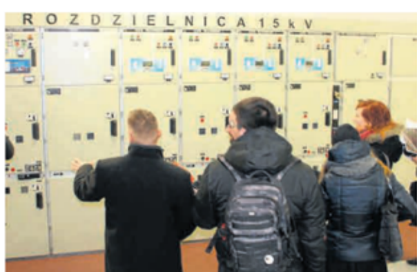
► Podstacja znajduje się w niepozornym budynku u zbiegu ulic Wróblewskiego i Bandurskiego na Retkini
